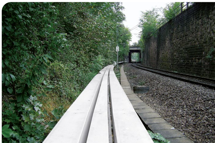
Drei parallel geführte Kabelkanäle auf einer Stütze
