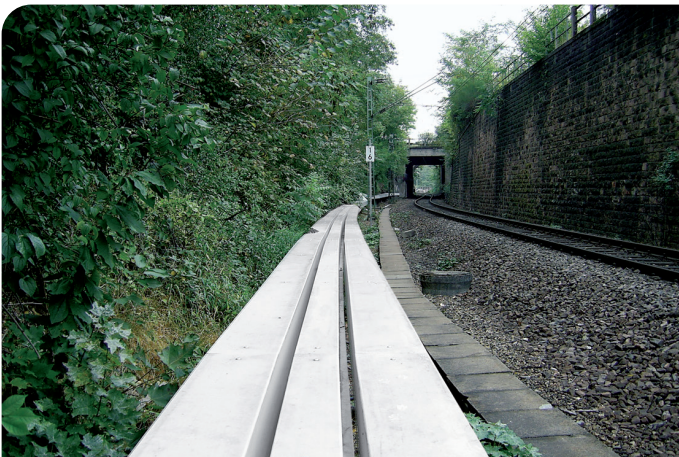
Drei parallel geführte Kabelkanäle auf einer Stütze
